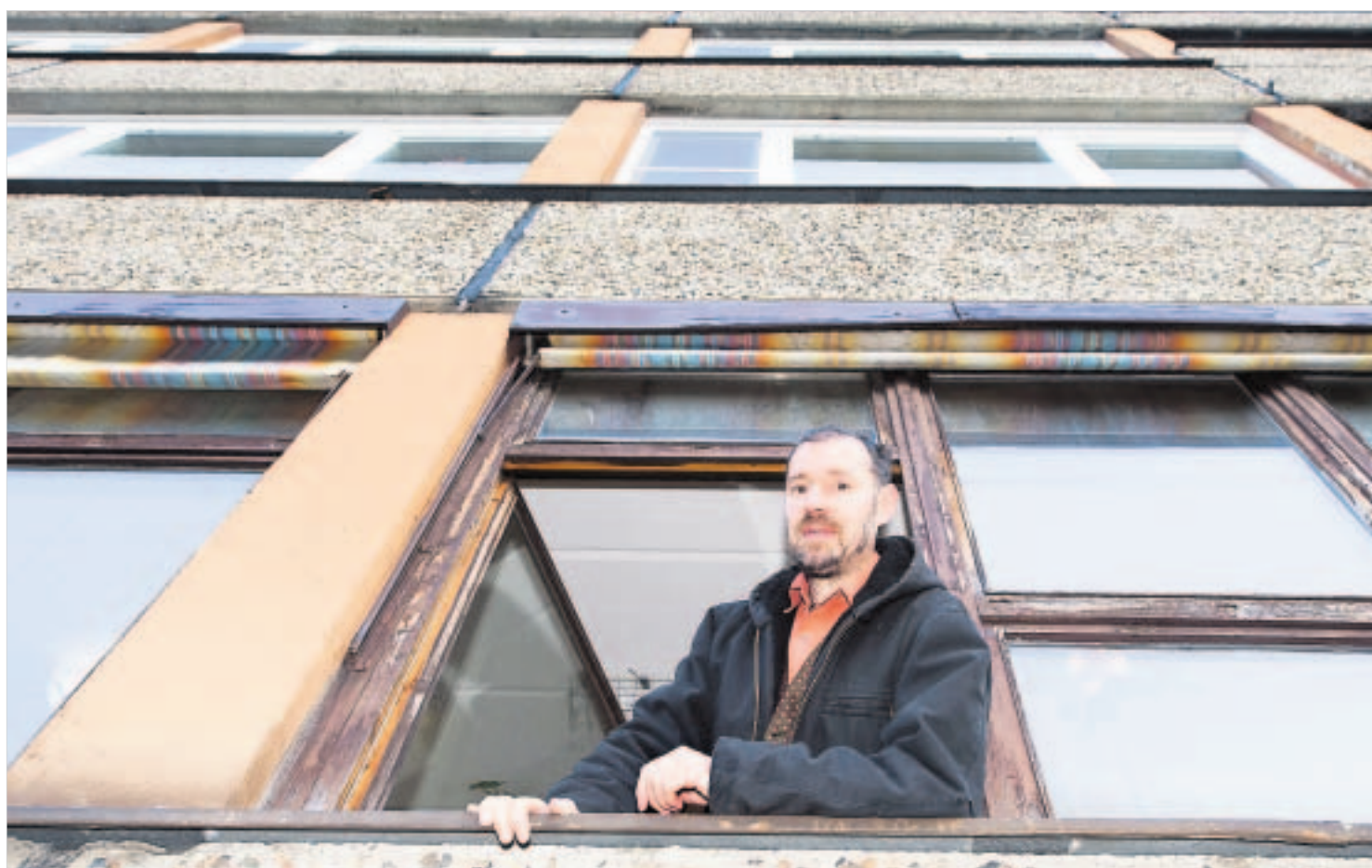
Die Fenster in der Laborschule müssen dringend saniert werden. Weil der freien Schule dafür das Geld fehlt, wurden bisher nur die Fenster in den oberen Etagen getauscht. Eine Elterninitiative will Schulleiter Daniel von Bahder jetzt bei der Finanzierung helfen. Foto: Steffen Unger
